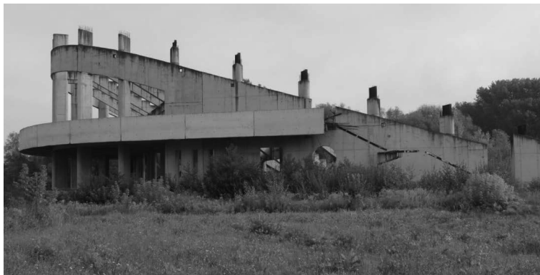
Obrázok 17 Opustená budova multifunkčnej športovej haly vo Zvolene
