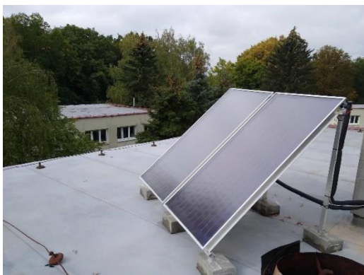
Obr. 1 Solárny ohrev vody pre školskú jedáleň
